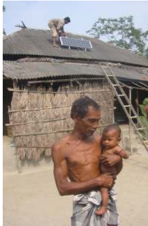
Sistema solar aislado instalado en Bangladesh
